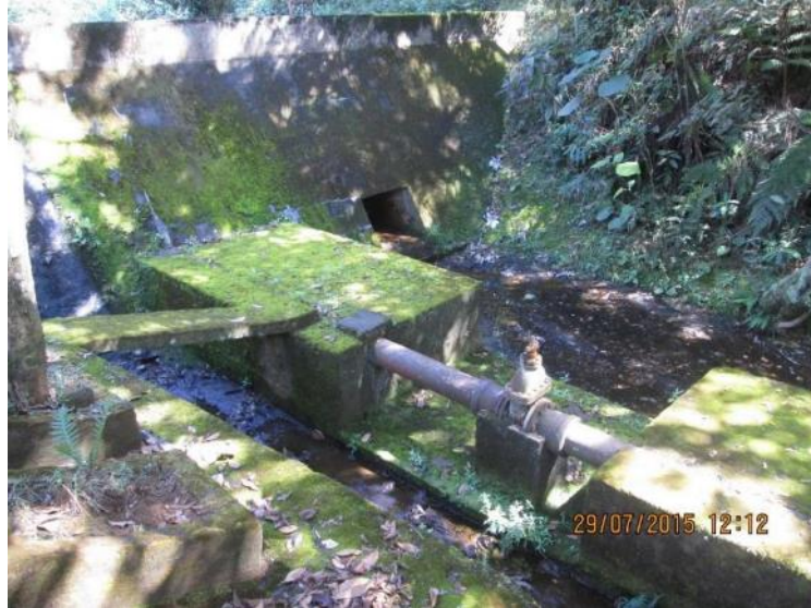
Figura 65 -Captação Córrego João Batista
