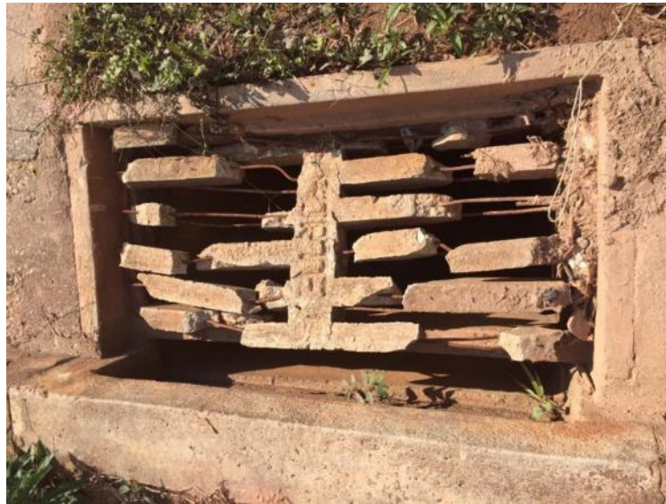
Figura 116: Boca de lobo deteriorada
