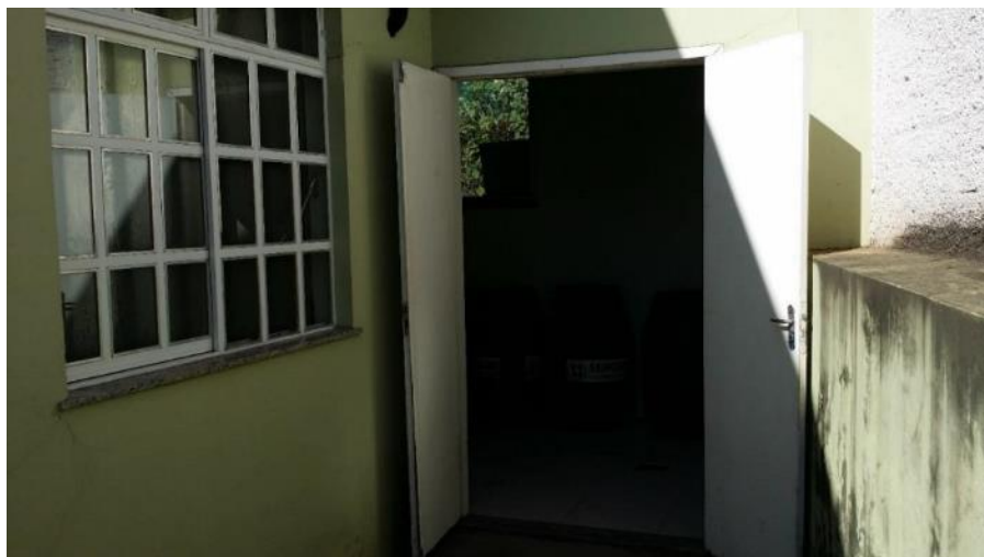
Figura 140 – Abrigo utilizado para armazenamento das bombonas contendo RSS – Pronto Atendimento
