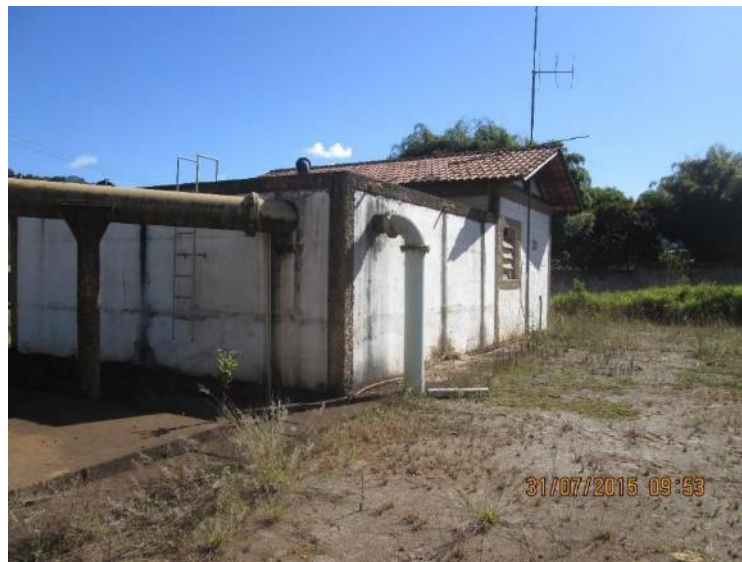
Figura 50 - Tanque de contato
