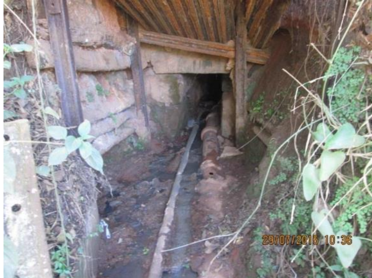
Figura 89 – Passagem do interceptor com sinais de entupimento
