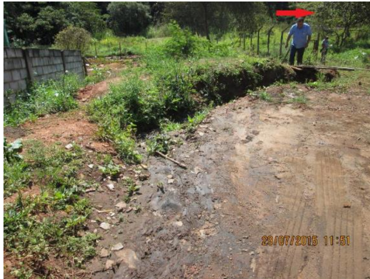
Figura 103 – Estação de Tratamento de Esgoto I - Pires
