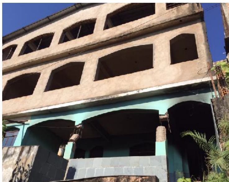
Figura 121: Casa desapropriada devido a movimentação de massa
