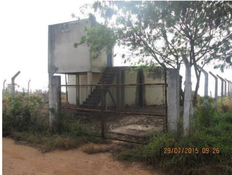
Figura 63 – Reservatório Localidade de Joaquim Murtinho
