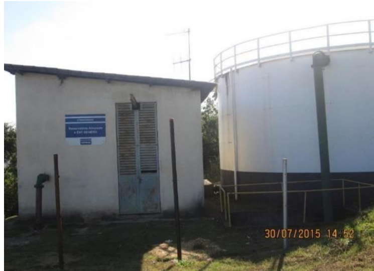
Figura 25 – Reservatório e estação elevatória Alvorada
