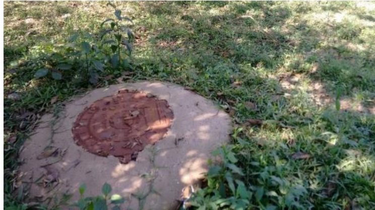
Figura 80 – Poço de visita - Interceptor da R. Bauá
