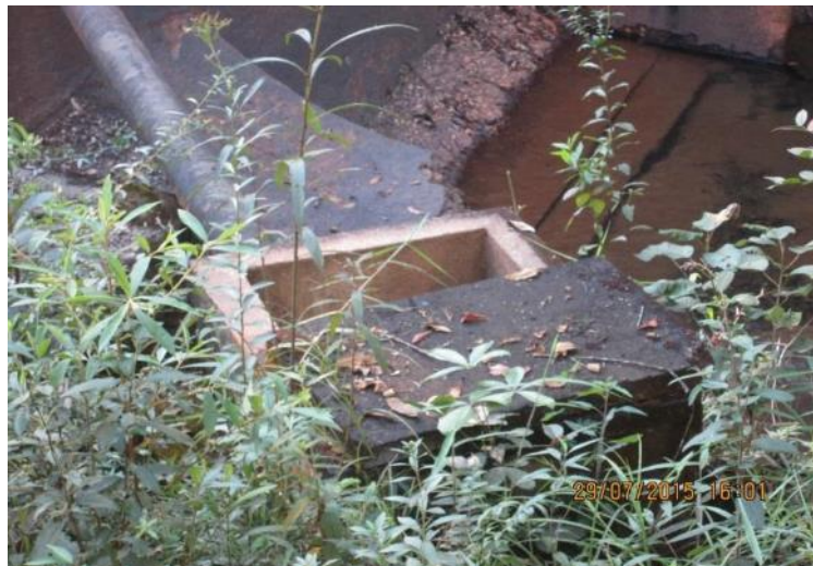
Figura 16 - Captação Córrego João Pereira
