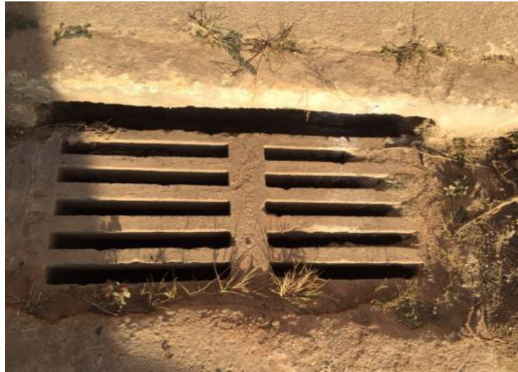
Figura 112: Boca de lobo Fonte: Projeta Engenharia (2015)
