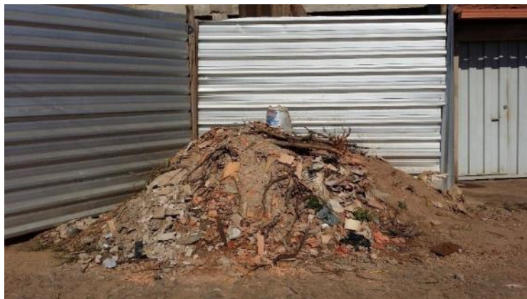
Figura 133 – RCC dispostos inadequadamente em via pública
