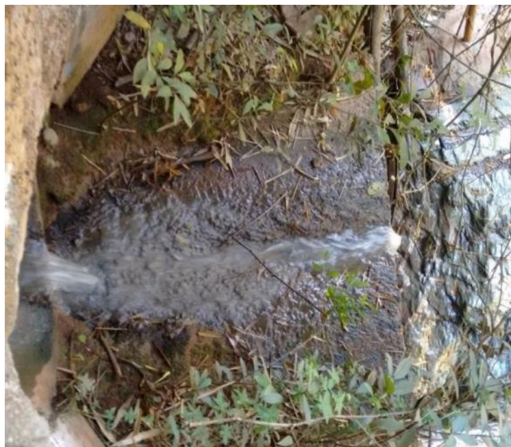
Figura 83 – Lançamento de esgoto proveniente dos Bairros Nova Cidade, Primavera e parte do Rosa Eulária
