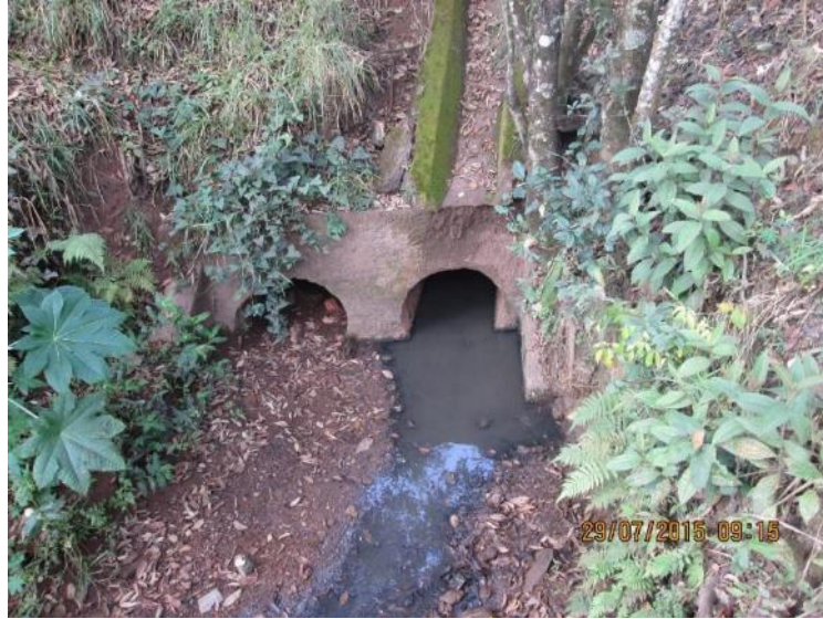
Figura 101 – Lançamento de esgoto em rede mista (pluvial + esgoto)
