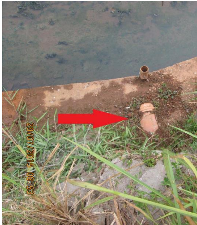
Figura 99 – Interceptor lançando esgoto proveniente da parte baixa do Leopoldina Barbosa
