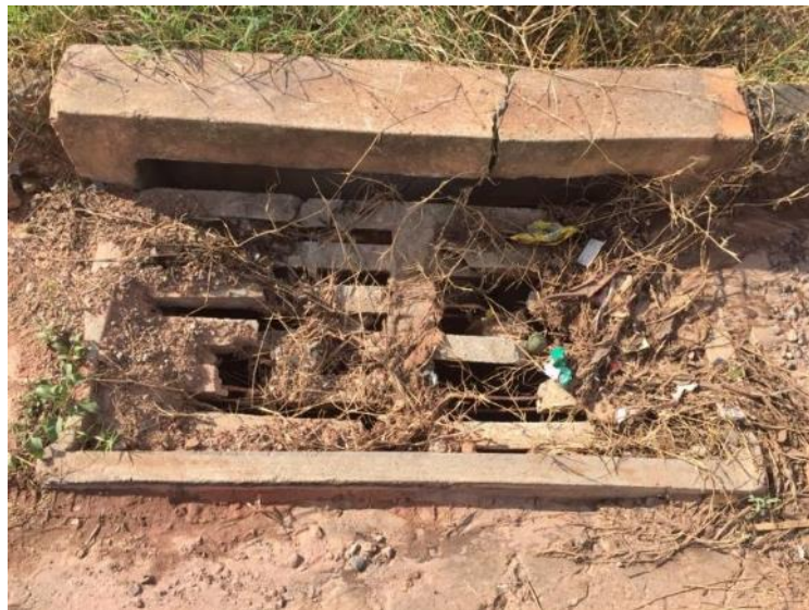
Figura 117: Boca de lobo deteriorada e com sinais de entupimento
