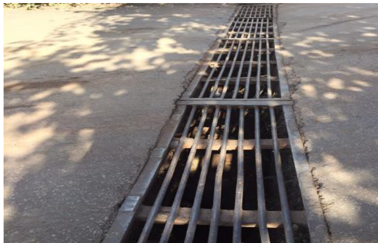
Figura 113: Grelha Fonte: Projeta Engenharia (2015)
