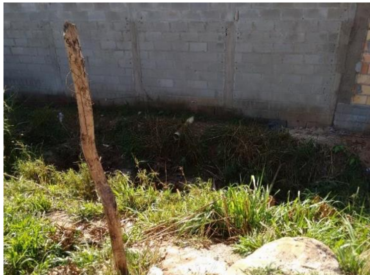
Figura 85 – Lançamento individual no Córrego Santo Antônio, Bairro Alvorada
