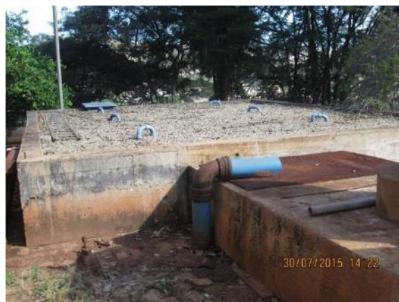
Figura 23 - Tanque de Contato
