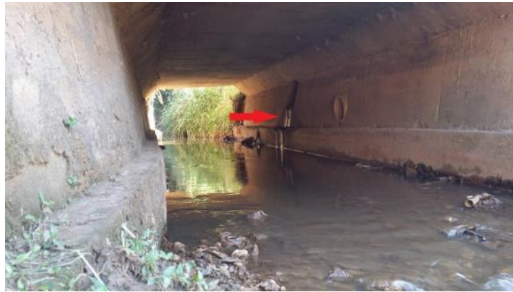
Figura 69 – Lançamento de esgoto sob a ponte da Rua Berilo
